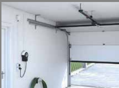
Řídicí jednotka v prostoru garáže
